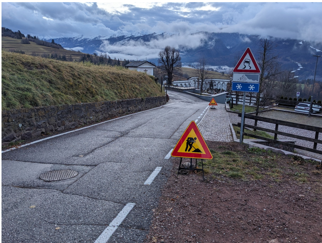
Tratto di via SS Pietro e Paolo a monte del punto di fuoriuscita
